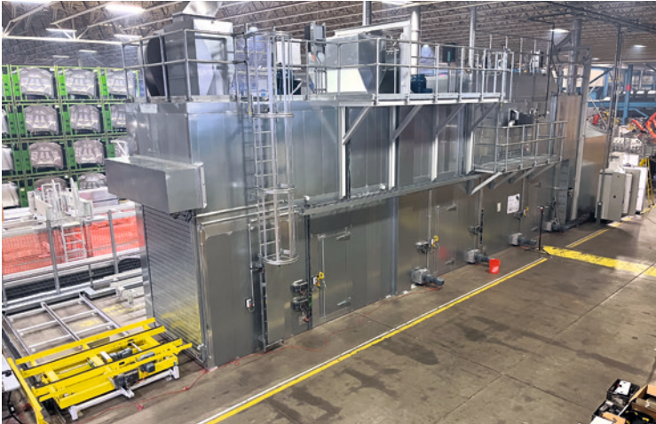
Komplexe Anlage: Durchlaufofen
